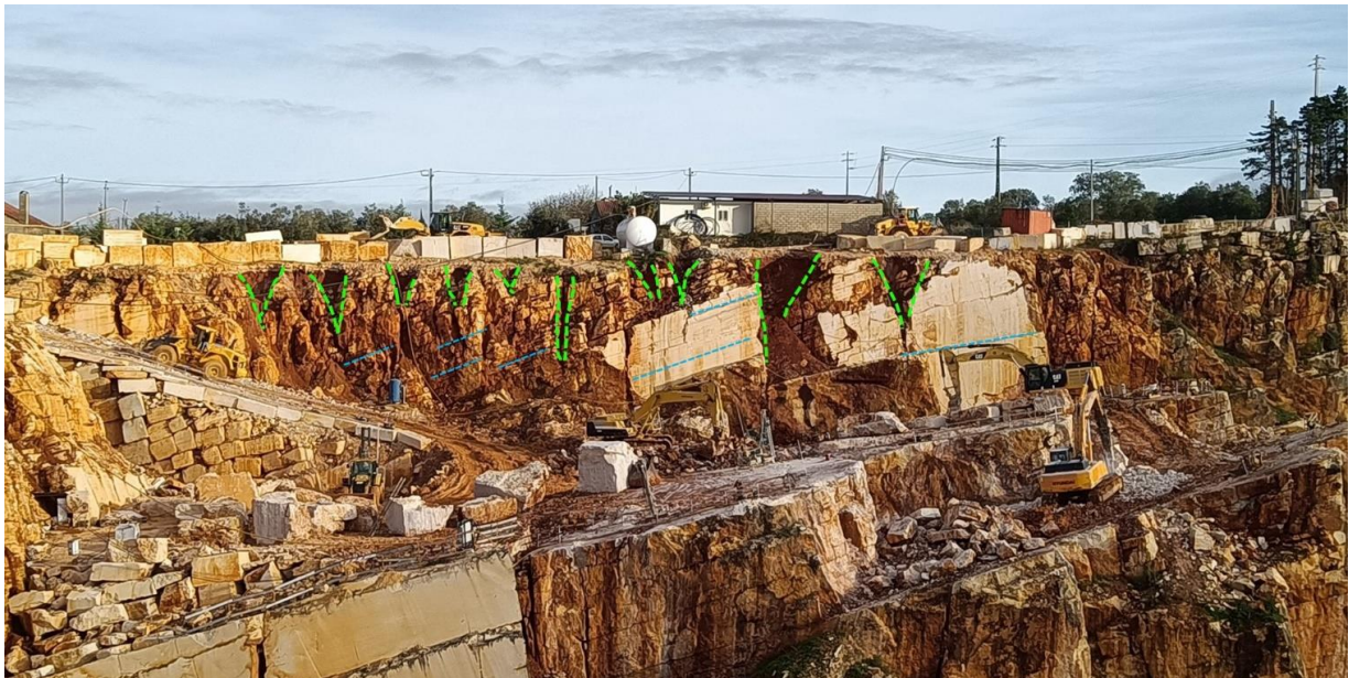
Fig. 2. Talude em estudo com sinalização de algares a verde e estratificação a azul.
